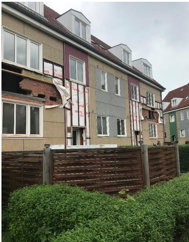
Renoveringen er godt i gang i blok B, hvor der er forberedt til montering af altaner. Bag ved ses de oprindelige røde mursten.
